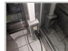
No.2 上記ホイスメント機 ホイスメント機 コンセント箇所
