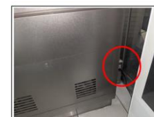
No.1 2階エレベーター内 ホイスメント機 コンセント箇所
