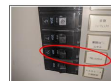
No.4 エレベーター内 エレベーター機 コンセント箇所
